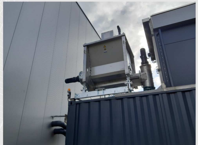
Vorlage Klärschlammtrichter mit Stopschnecke
