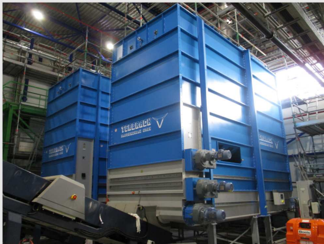
Vario, Teil VA, Mittelaustrag auf Förderband
